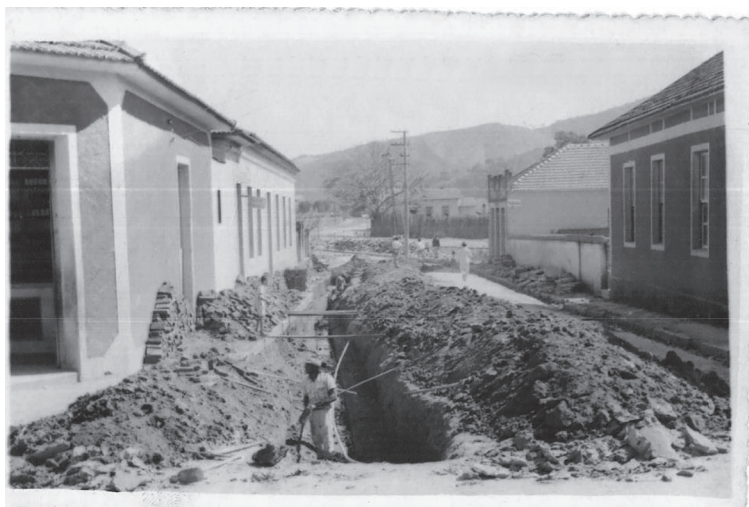
Obras no bairro Turquia – calçamento e serviço de esgoto, em 1952. Acervo: Grupo Maria da Fé Antiga.
